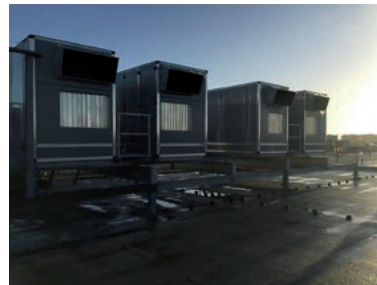
Foto Switch Datacenters
