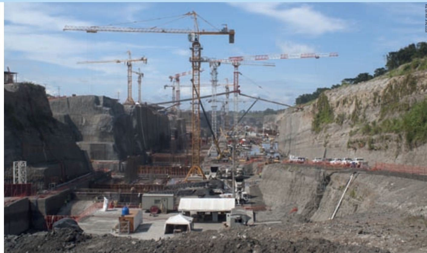
De bouwplaats aan de Atlantische zijde oogt als een beeldhouwwerk. De zachte Gatúnrots wordt met graafmachines en frezen verwijderd.
