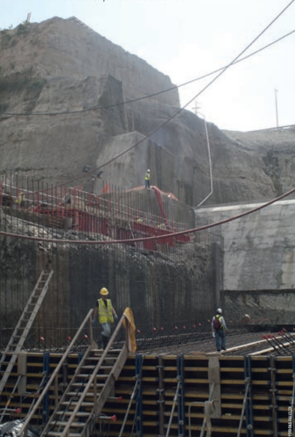
Een van de zes trifurcaties aan de Atlantische zijde, die de sluis kamers met de waterbesparende reservoirs verbinden.
