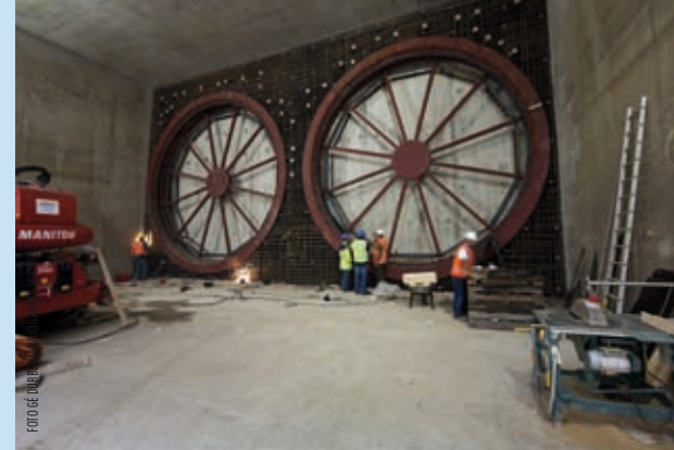
De kopse zijde van de start-schacht is voorzien van een brilwand. Deze constructie heeft een waterkerende functie en garandeert de integriteit van de wand.
