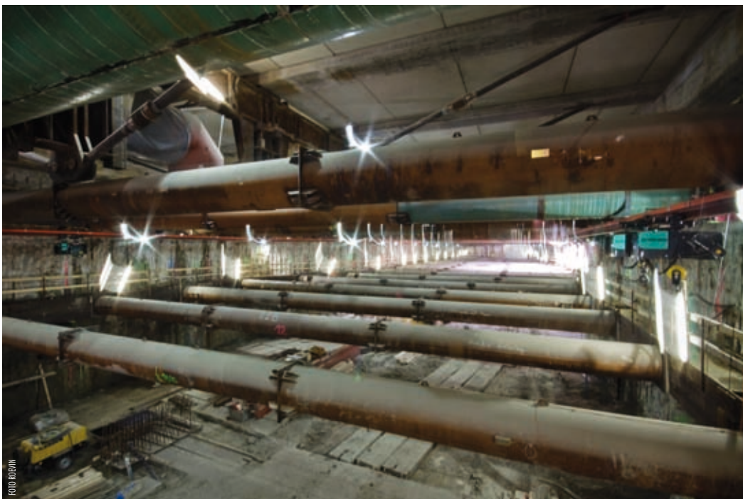
Lekkages in de diepwanden van station Vijzelgracht zorgden voor grote zettingen. Uit voorzorg wordt de grond bij de diepwandvoegen nu bevroren.
