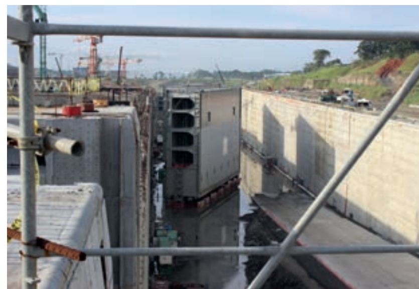
Het inrijden van een sluisdeur in de kolk.
